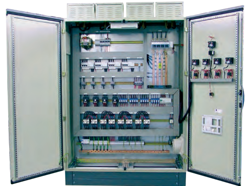
Armoire de démarrage automatique
