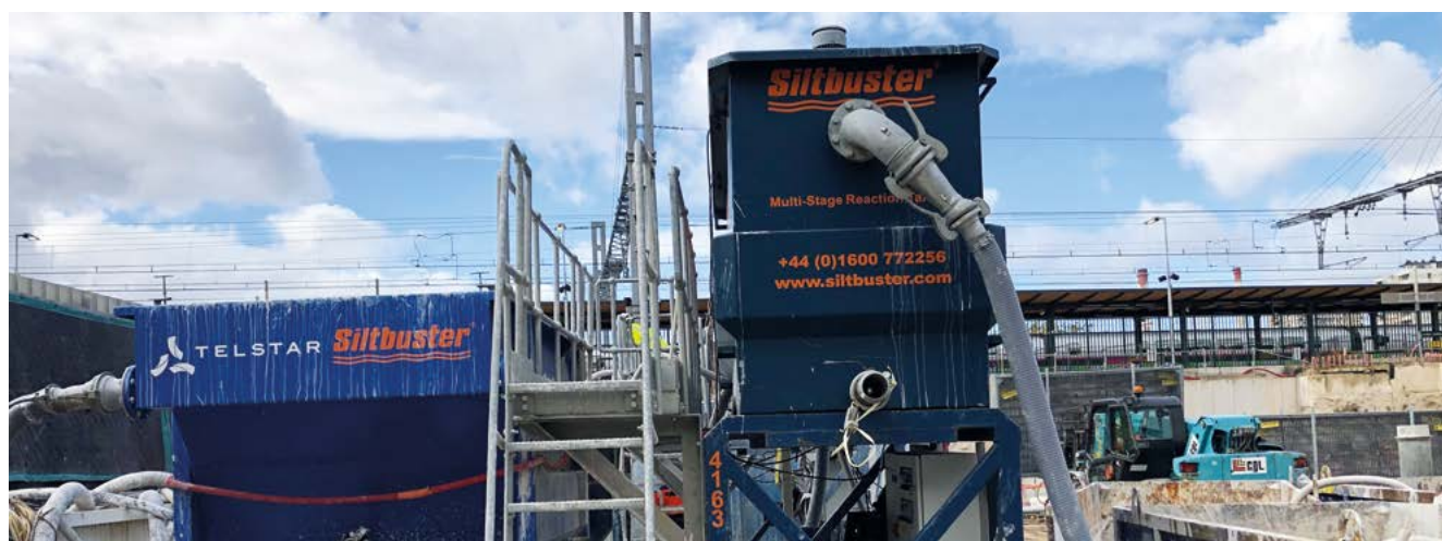
Décantation avec dosage chimique
