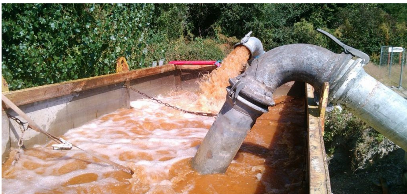
Le bac de décantation
