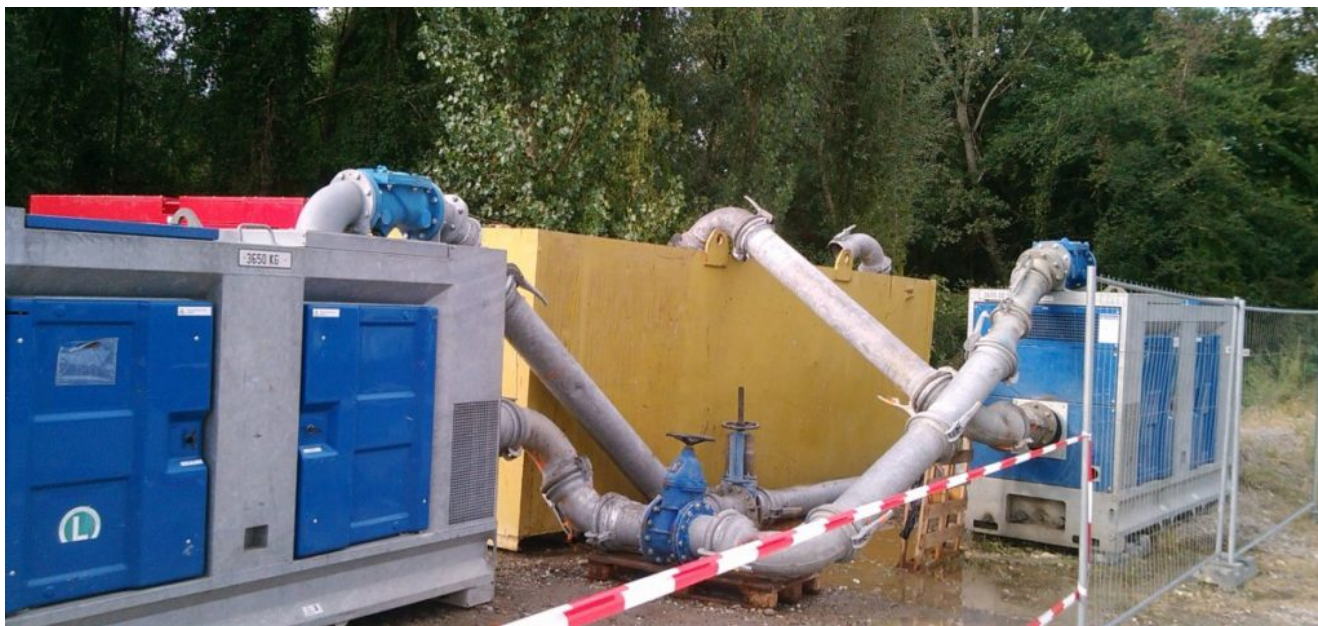
L'installation des deux BBA en série
