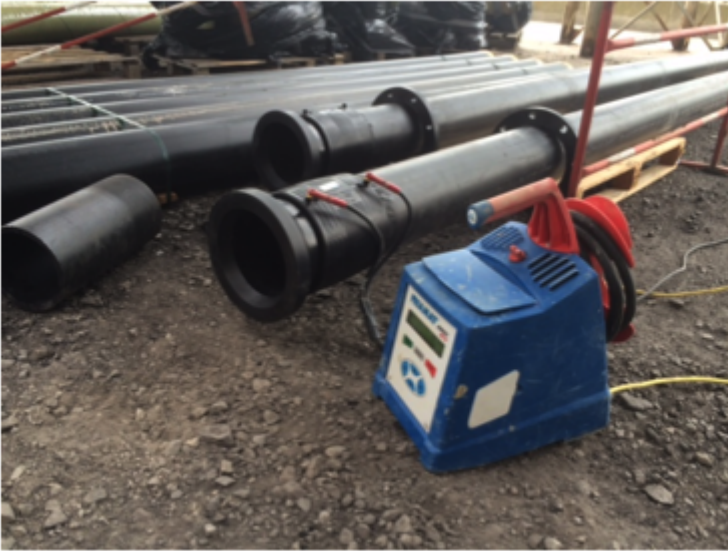
Les tuyaux de refoulement
