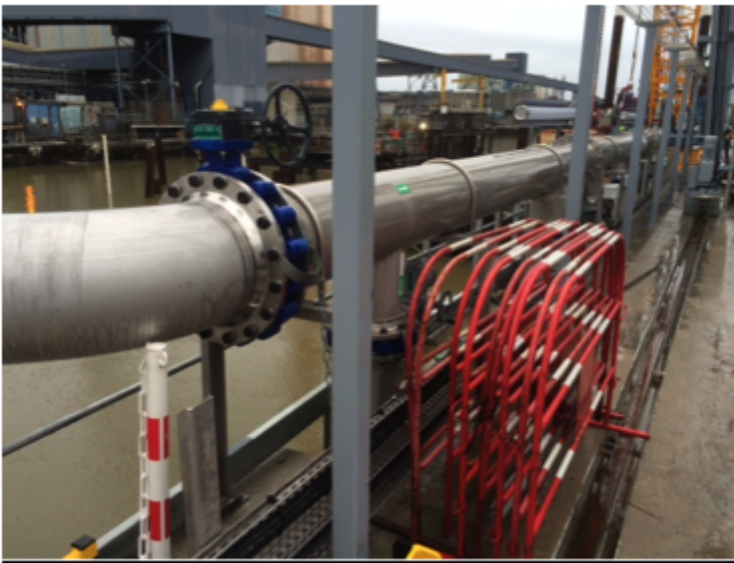
La canalisation où doit se raccorder la Méga
