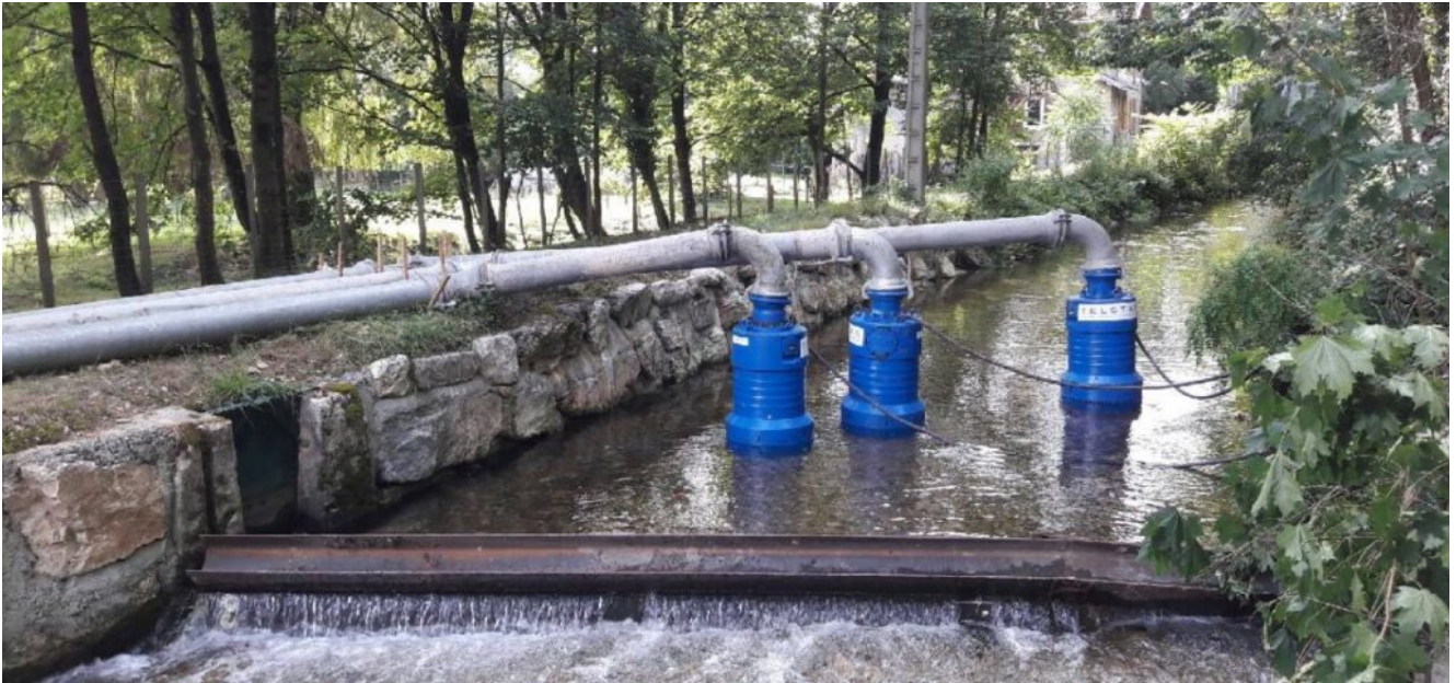
L'installation des Magnum
