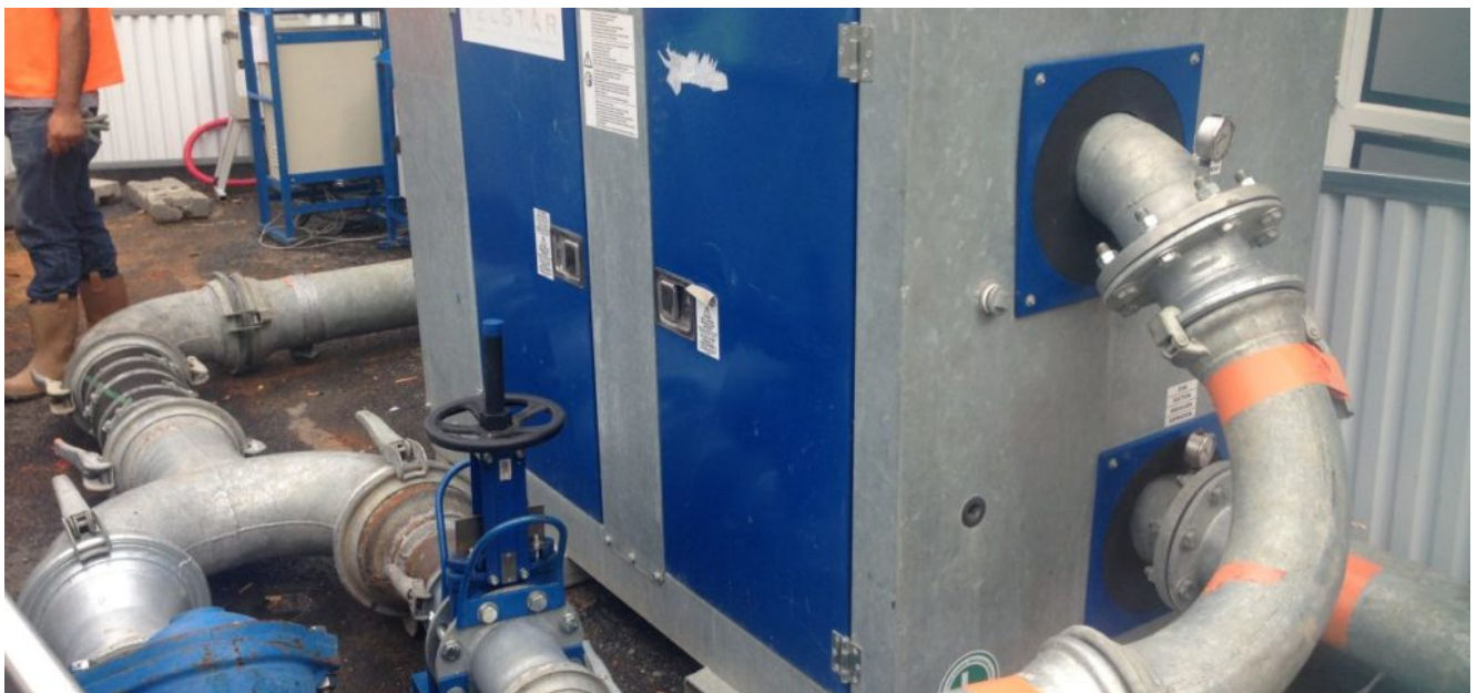
La deuxième station avec l'Hidrostal H 150 ...
