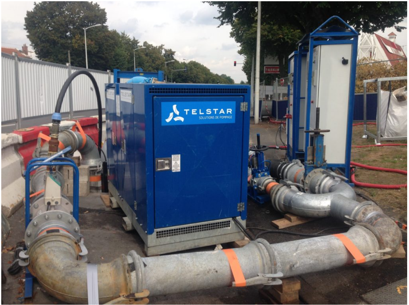
A gauche, les évacuations qui vont descendre dans le collecteur
