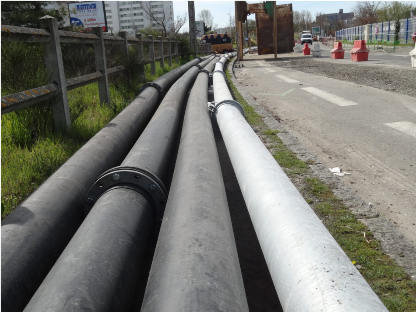
Les 4 lignes du by-pass installées
