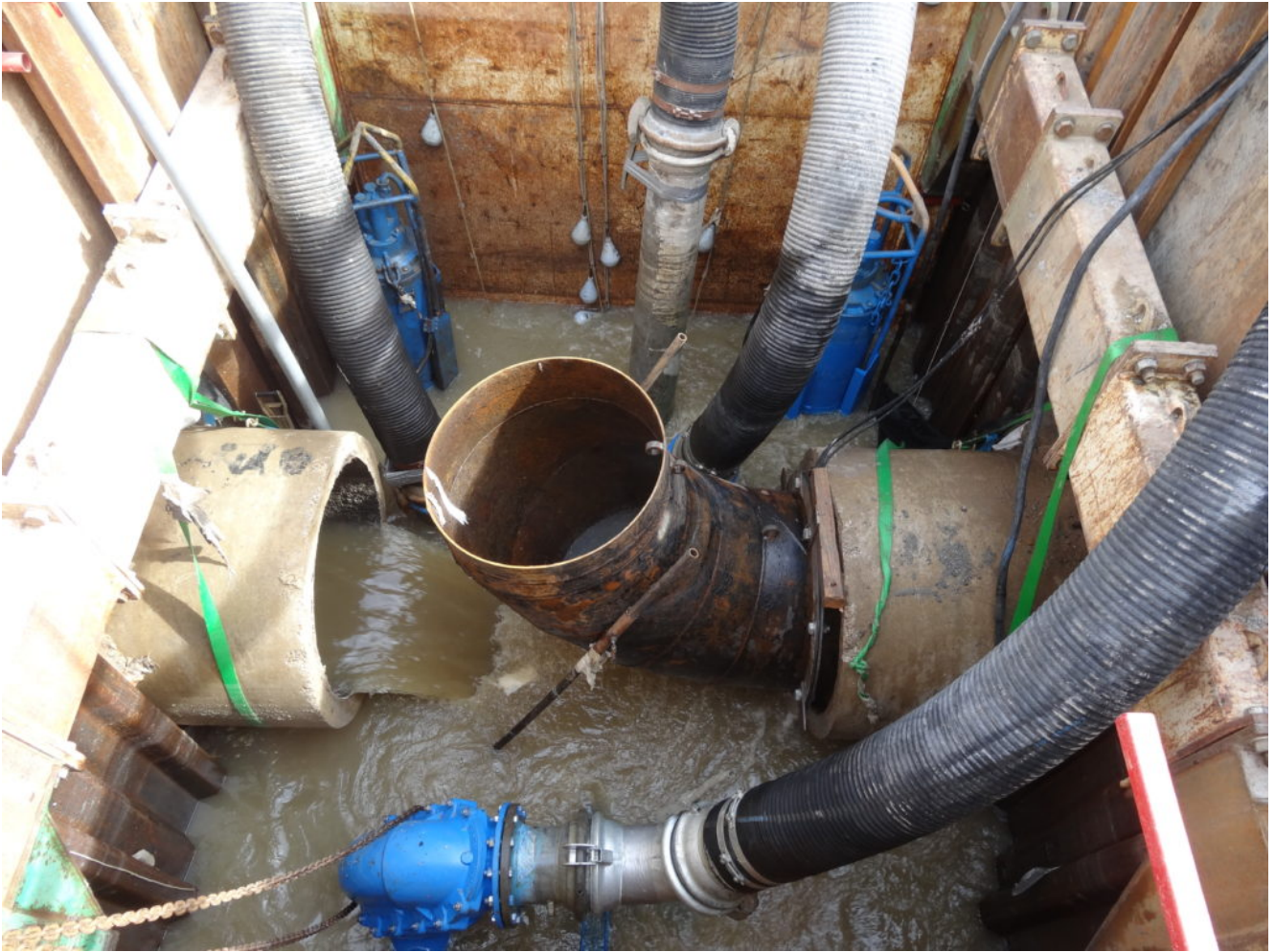
Les 3 Hidrostat F10K immergées et les régulateurs de niveau
