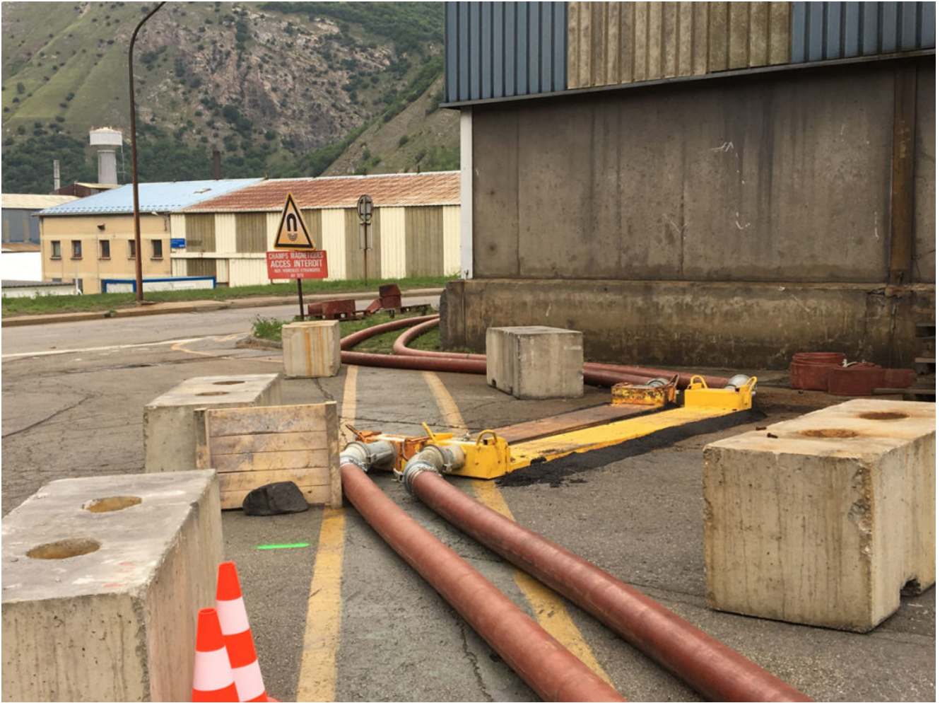
La seconde pompe pour l'alimentation d'une aluminerie
