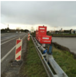
Tuyaux le long de la route
