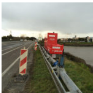
Tuyaux le long de la route
